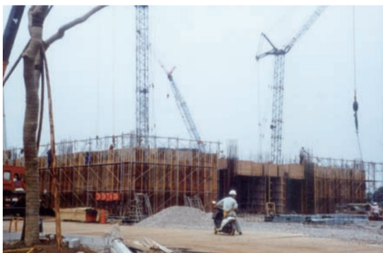
当時の岩槻キャンパスの工事風景。 ここに人文学部地域文化学科・言語文化学科が開学した。
